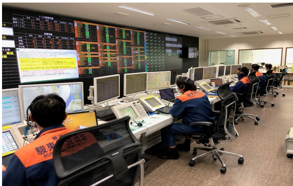
消防指令センター 高機能消防指令システム（Ⅲ型）
