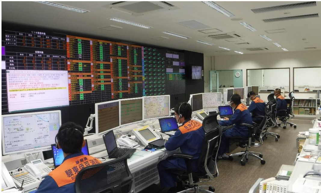
消防指令センター 高機能消防指令システム（Ⅲ型）
